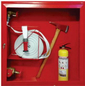
GABINETE CONTRA INCENDIOS DOTADO CLASE 1 - 2 Y 3
